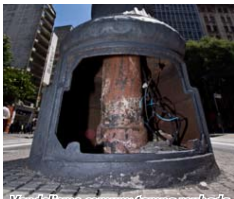
Vandalismo comum: tampa roubada
